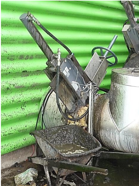
Sortie / Entrée digesteur.....passée
