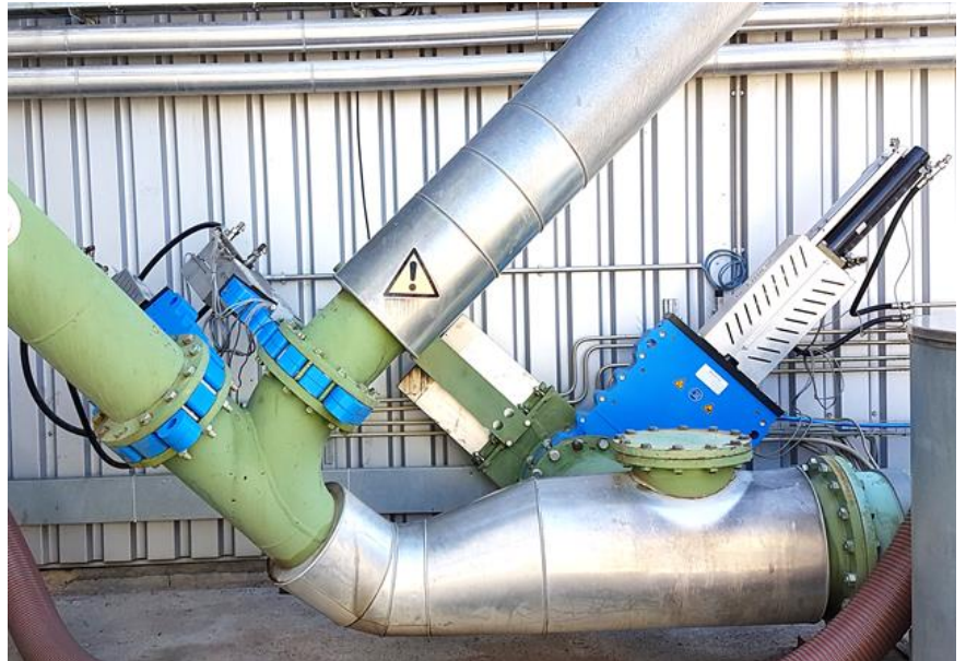
Sortie / Entrée digesteur.....actuelle
